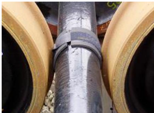
Obr.4 Uskladnění na dvojitě koleji - ochrana proti dotyku
